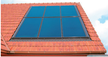
Praxisbeispiel für die Anwendung von Solarthermie-Flachkollektoren Example of flat plate collector installations
