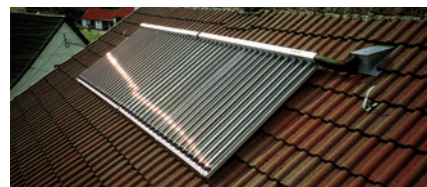
Anlagenbeispiel – Vakuumröhrenkollektor Example of solar installations – Vacuum tube collector
